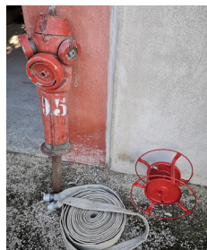
La borne, le tuyau et le dévidoir
